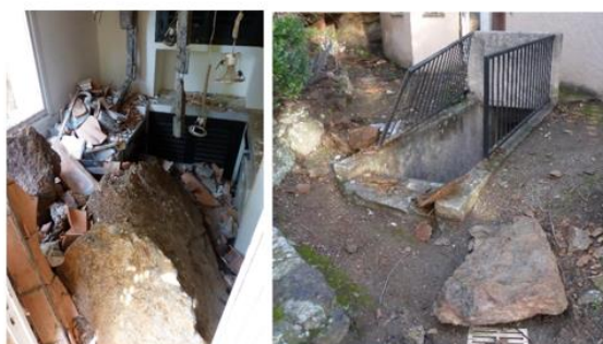
Dégâts observés // Source : Etude ERG Géotechnique
