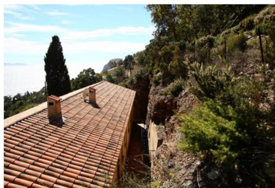
Encastrement justifiant l'exposition des villas face au risque // Source : Etude ERG Géotechnique
