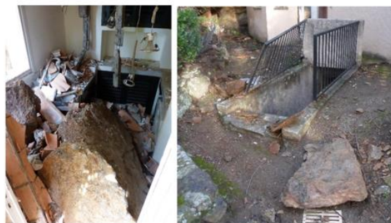
Dégâts observés // Source : Etude ERG Géotechnique
